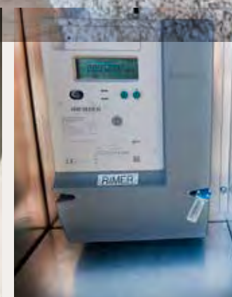
Lavenergi-huset bruker svært lite strøm.
