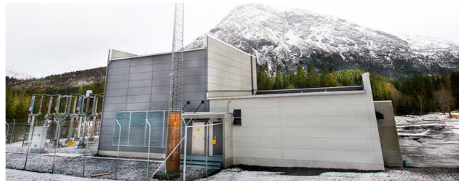
For å forsterke forsyningen over hele Helgeland er det blant annet satt i drift en ny trafostasjon i Tosbotn i 2015.
